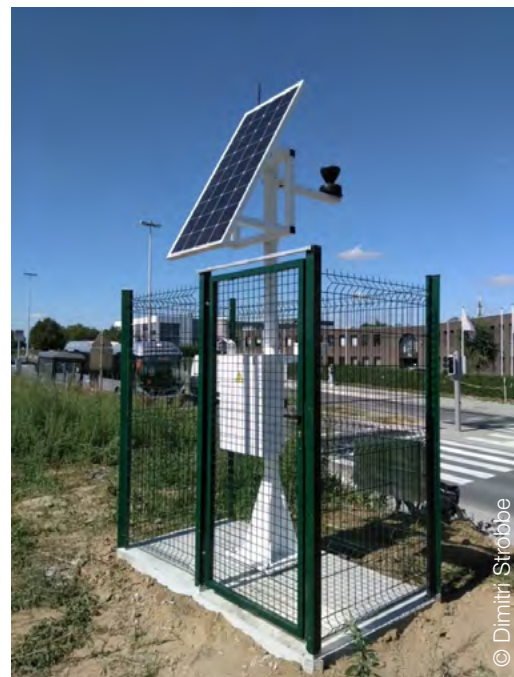
> La nouvelle station météorologique de l'avenue de Tyras
